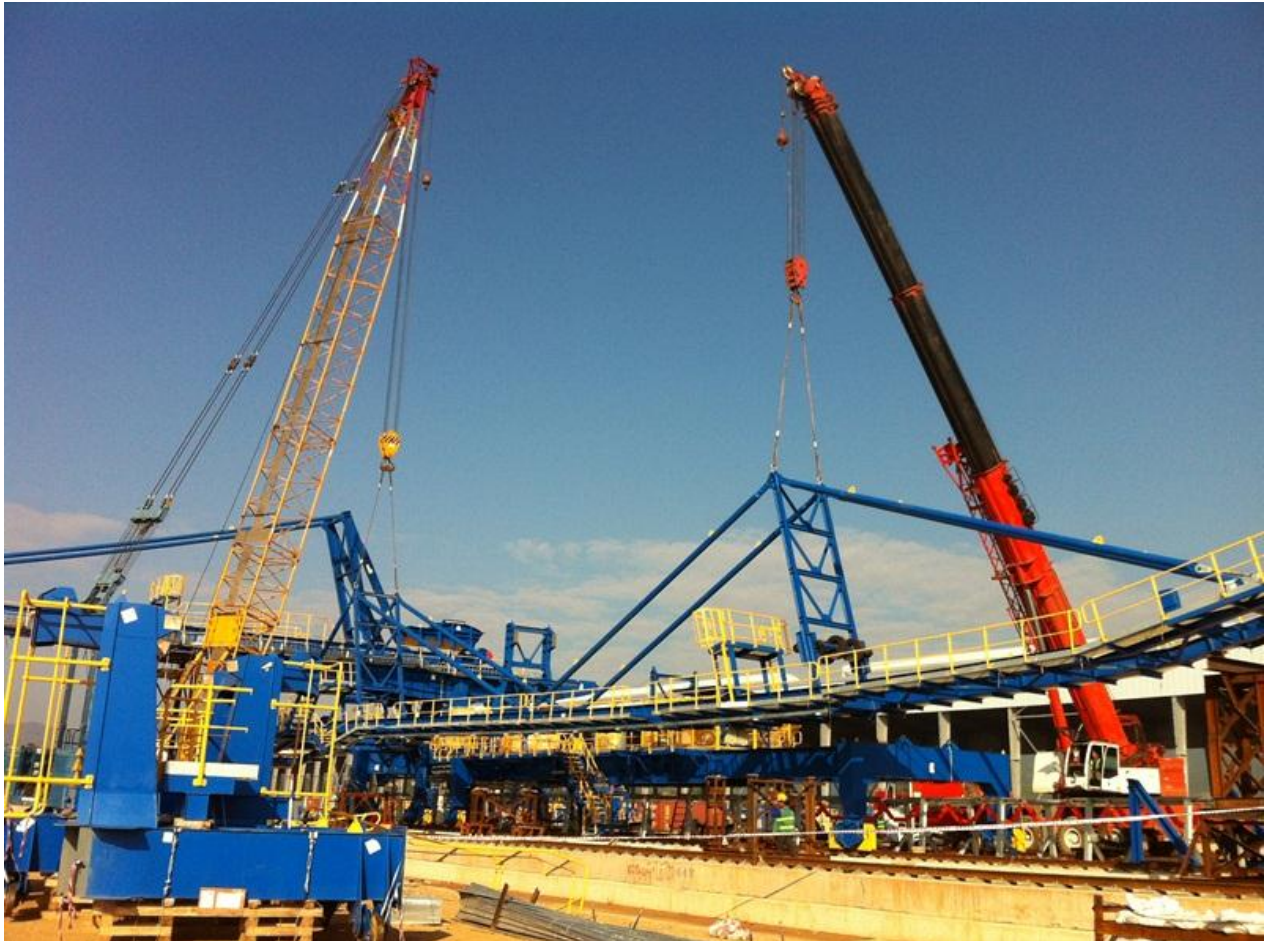
Công trình nhiệt điện Hongsa – Lào
