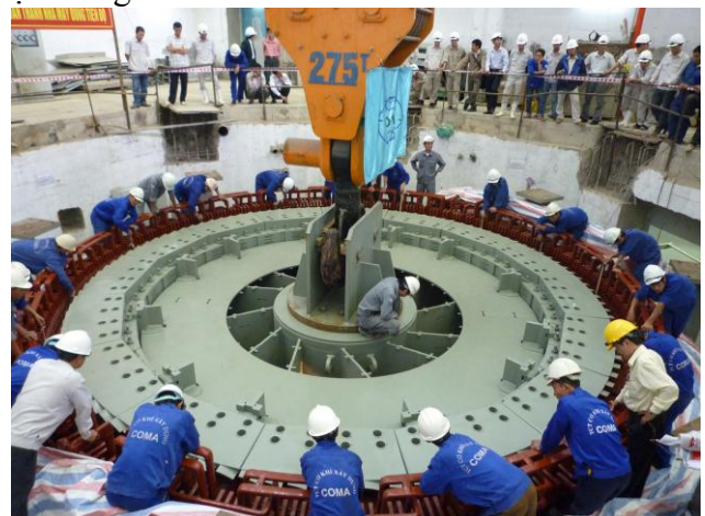
Công trình Thủy điện Sông Tranh
